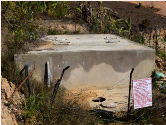
नेर्पा बजार खानेपानी योजनाको रिजर्व ट्यांकी त्रिवेणी-५
